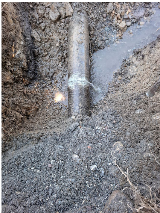
Bildlegende: Die schadhafte Stelle der Verbindungsleitung Niederurnen–Weesen in der Uferböschung beim Birchgraben.
