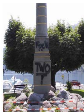
Sprayereien an der Wasserstandsäule
